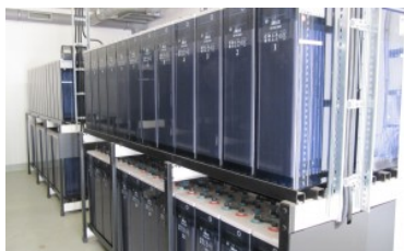
Batería Estacionaria BAE 16 PVS 3040
