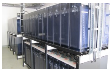
Batería Estacionaria BAE 16 PVS 3040
