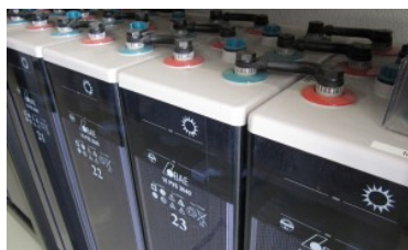
Batería Estacionaria BAE 16 PVS 3040
